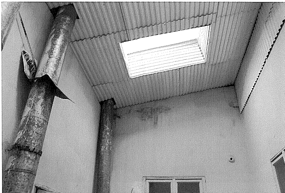
Projevy zatékání do světlíku v severním křídle
