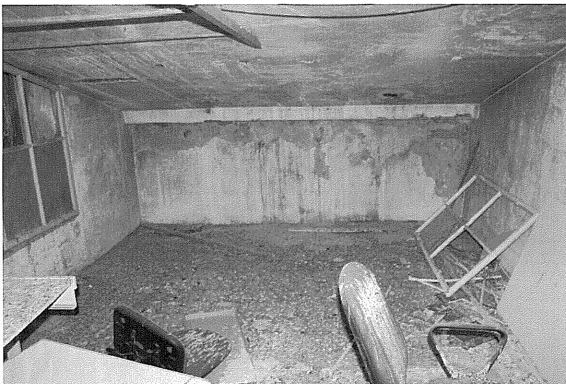
Zatékání do prostoru 352
