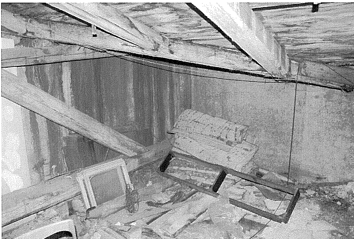
Projevy zatékání do půdy – prostor 359
