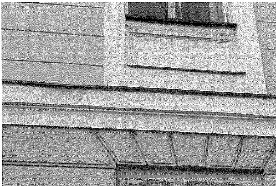
Statické poruchy na východní fasádě
