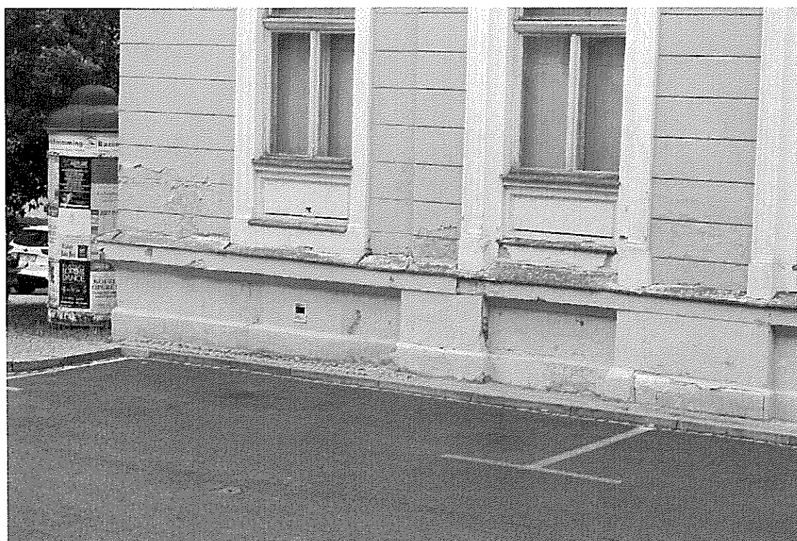
Detail poruch na západní fasádě
