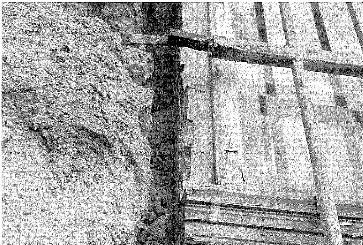
Detail poruch výplní východní fasády
