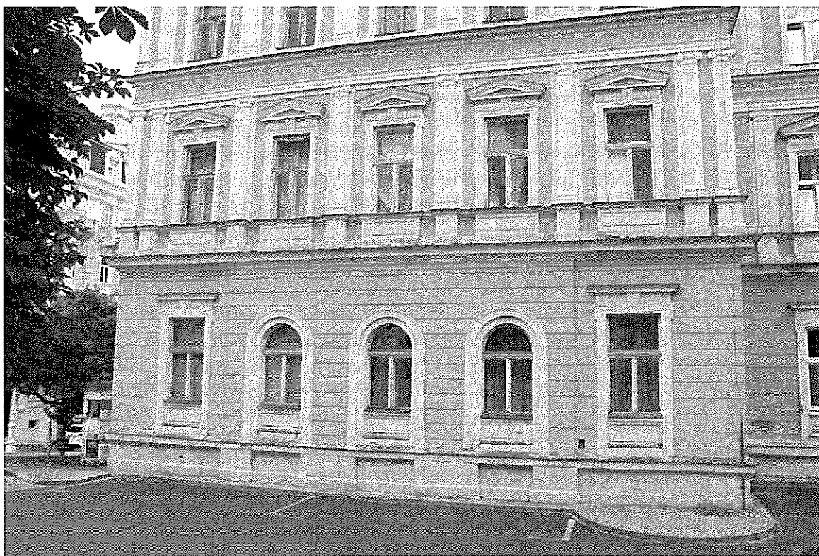
Poruchy na západní fasádě
