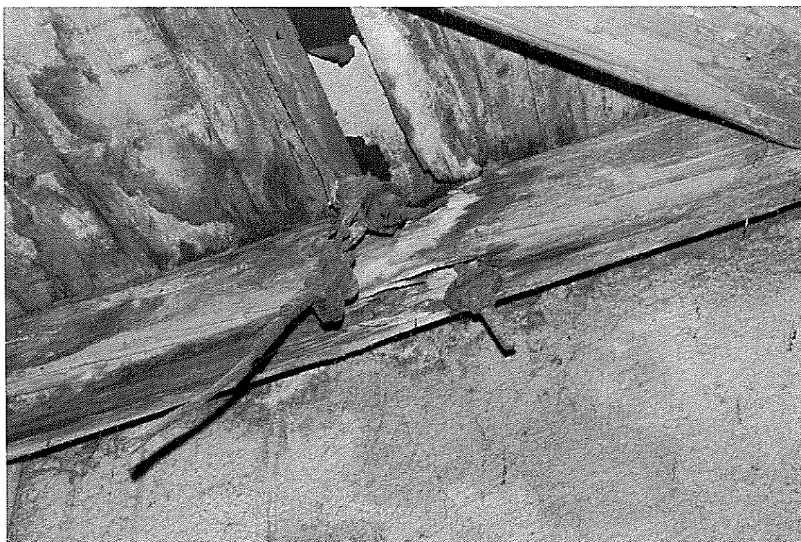
Zatékání do půdy – prostor 353
