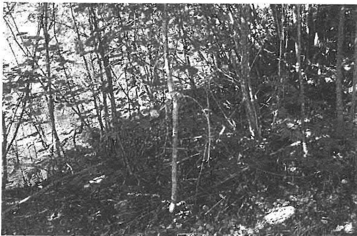
Vegetace ostoucí na vzdušném svahu hráze znemožňující kontrolu stavu průsaků a bránící vývoji travního drnu Závada závažnosti 1
