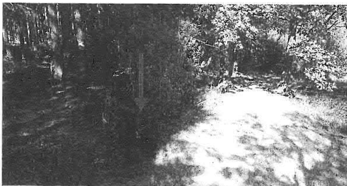
V korytě obtokové stoky se vyskytuje plevelná vegetace bránící odtoku
