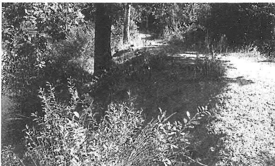
Nátrž návodního svahu vlivem chybějícího opevnění a nezapojeného travního drnu Závada závažnosti 2
