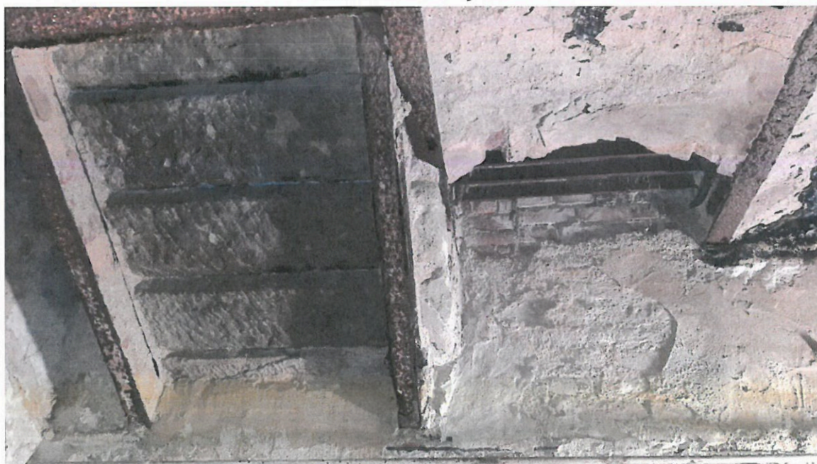
Obr.6 – Stav stropní konstrukce – silná degradace ocelových profilů
