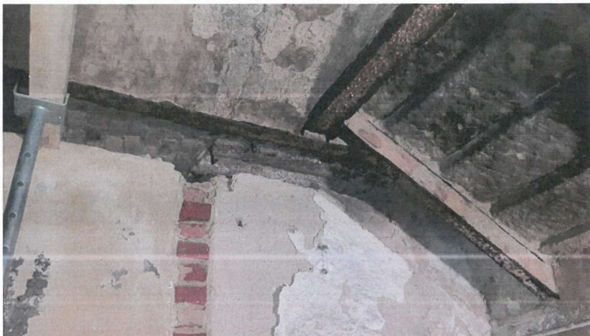
Obr.5 – Stav stropní konstrukce – silná degradace ocelových profilů, zde pokračuje klenba do sousedního objektu
