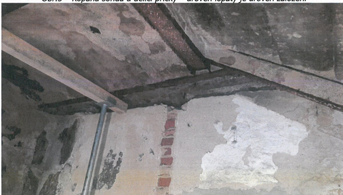
Obr.4 – Stav stropní konstrukce – silná degradace ocelových profilů, zde pokračuje klenba do sousedního objektu
